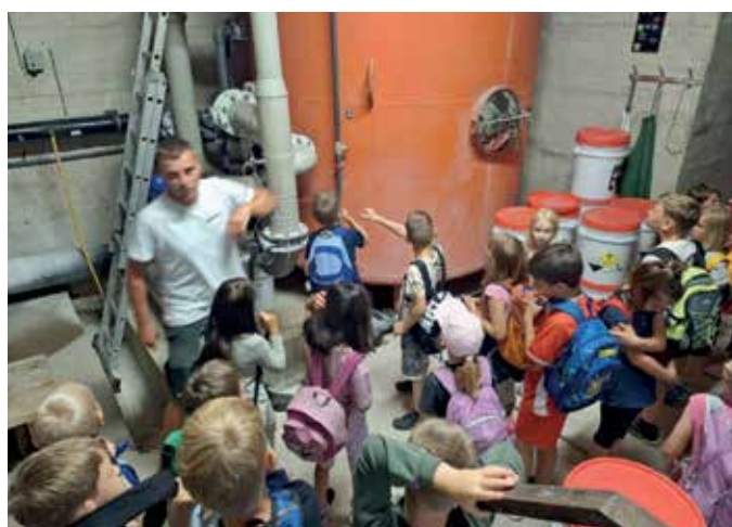
Technikraum des Schwimmbades
